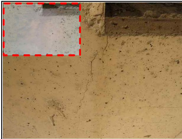
교각 균열(폭 0.2mm)(보수완료)
