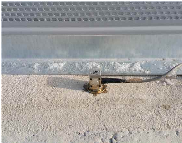
가속도계 설치 현황
