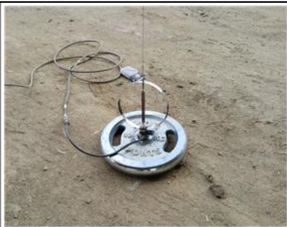
처짐계 설치 현황
