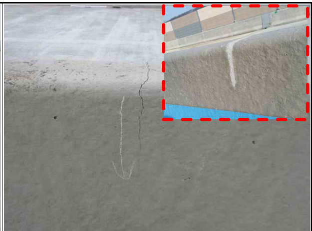
중분대 균열(폭 0.2mm)(보수완료)
